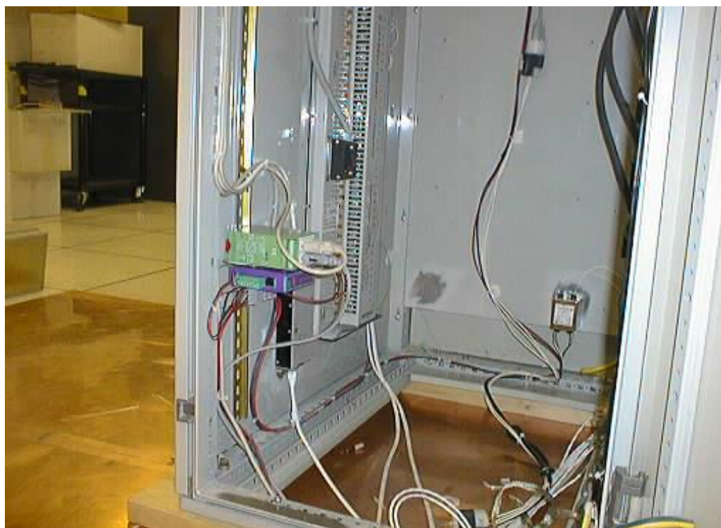
図 14-9b. ケーブル入口#2
